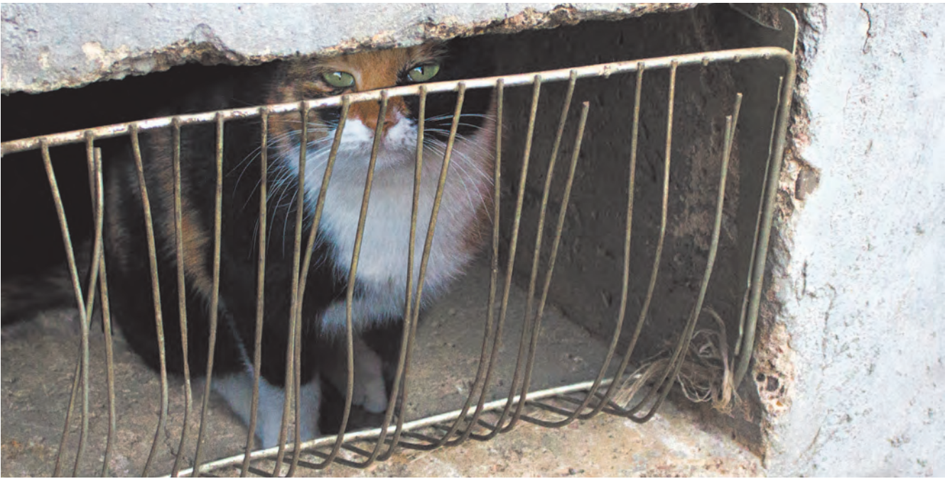
▲ Животные остались запертыми в подвальном помещении
